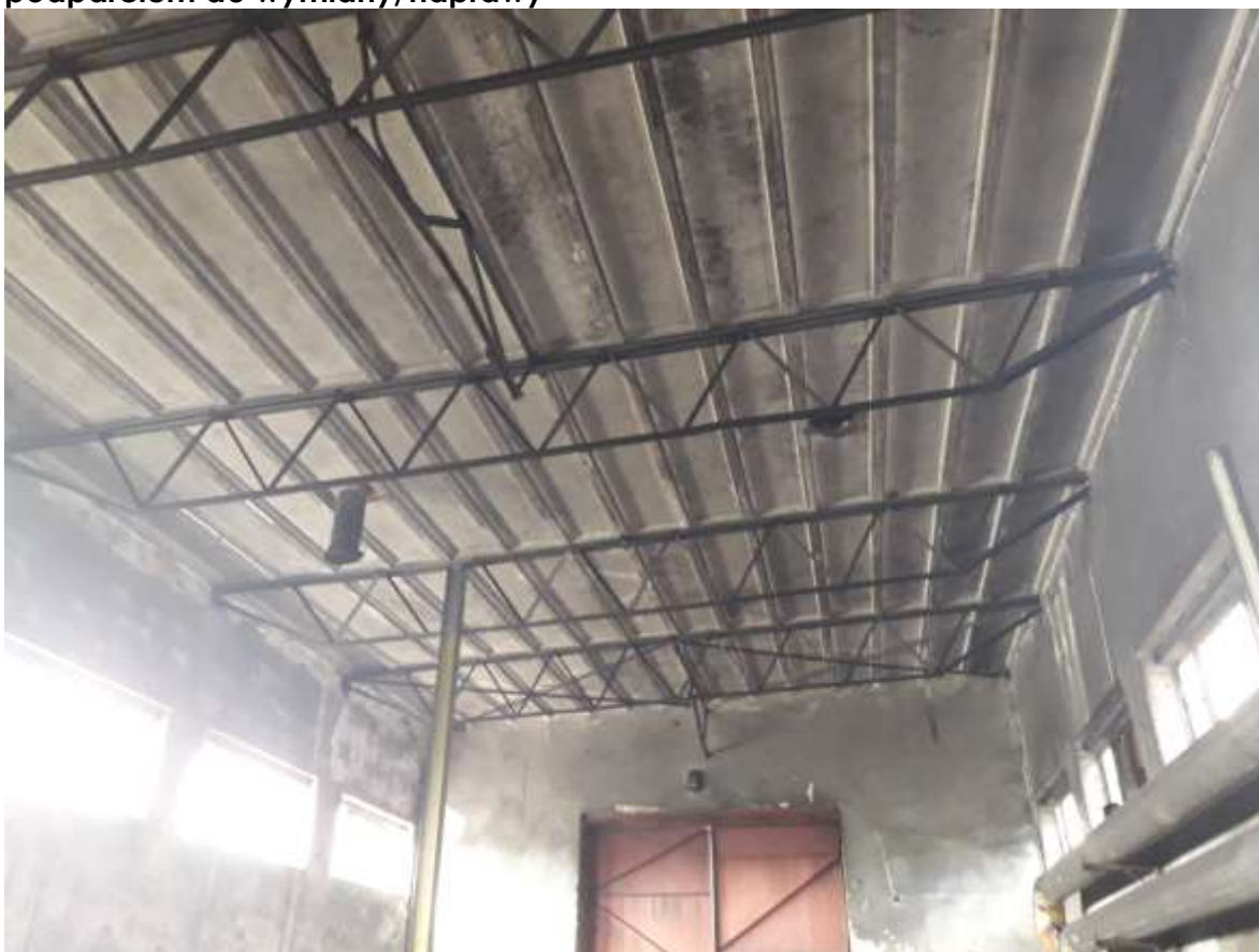
Zdjęcie nr 17 – strop nad pomieszczeniem składu węgla, dźwigar z wykonanym podparciem do wymiany/naprawy
